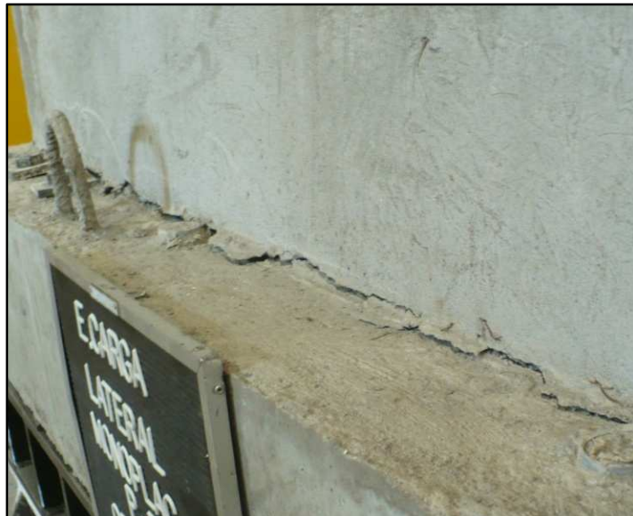
Foto 13. Modo de falla de la muestra N° 3. Falla por desprendimiento del panel de la viga de fundación.
